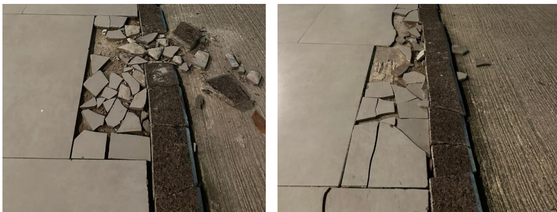
Imagens 03 e 04: Piso do acesso do Hotel danificado pelo tráfego de veículos.
