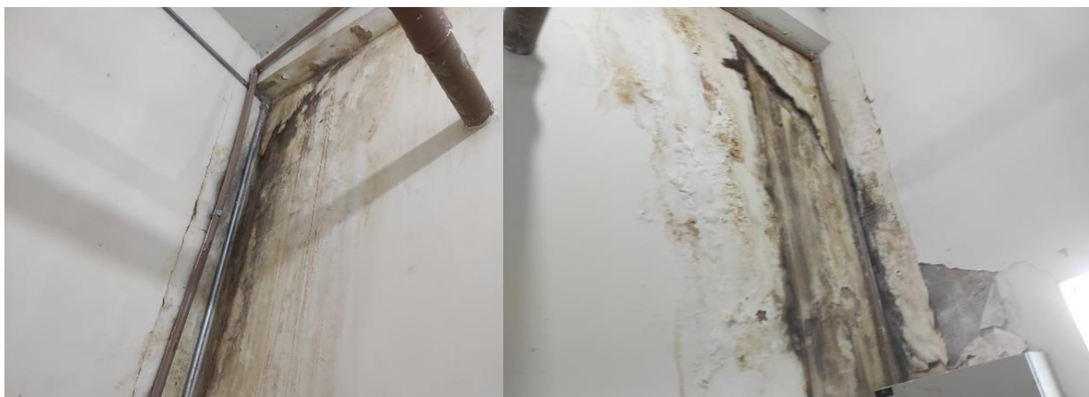
Imagens 01 e 02: Vazamento dos 2 (dois) reservatórios elevados do Hotel.
